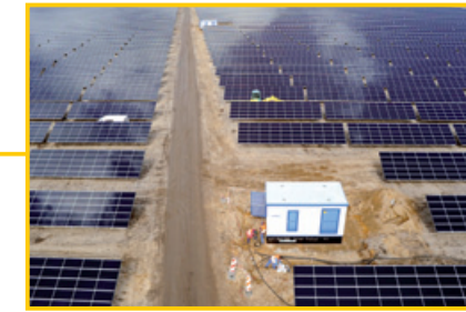
Modulfeld mit Wechselrichterstation
