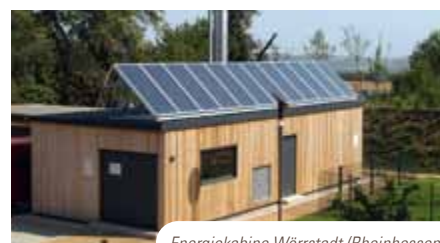
Energiekabine Wörrstadt (Rhein Hessen)
