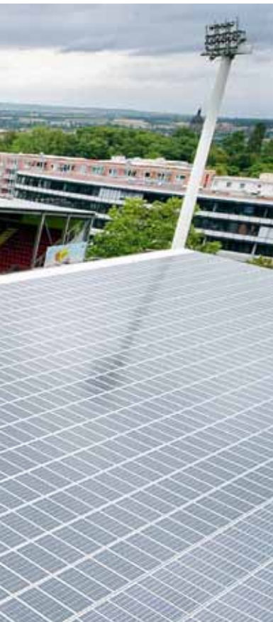
Das Photovoltaik-Dach auf dem Mainzer Bruchwegstadion ist ein Gemeinschaftsprojekt von Stillger & Stahl und juwi.
