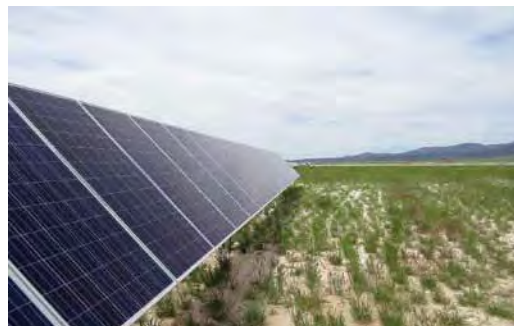
Viel Platz für die Solarenergie: Nach dem Projekt Pavant I im vergangenen Jahr baut juwi in Utah jetzt ein mit 62,7 Megawatt nahezu gleichgroßes Sonnenkraftwerk.
