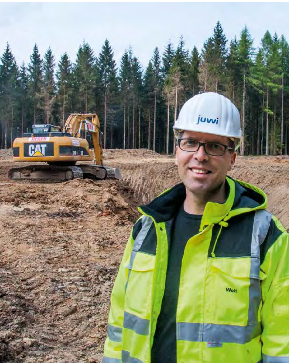
Ingo Wolf (r.) leitet für juwi den Bau des Windparks Obere Kyll in der Eifel, Torsten Schopbach begleitet am Hunsrück-Standort Norath Ausgleichsmaßnahmen für den Bau des dortigen Windparks.
